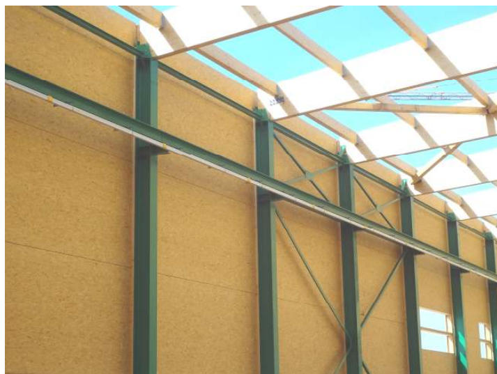
Hall de production Menuiserie Hunsinger – Thal Drulingen Surface 2160 m 2 (72 x 30m), hauteur 14m Isolation en mur et toiture R=6m 2 K/W
